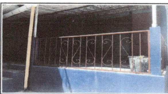
Foto 12: Pasamanos de metal para el corredor
