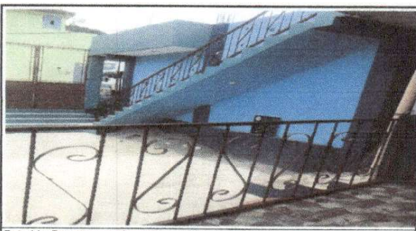
Foto11: Pasamanos de metal para el corredor y gradas
