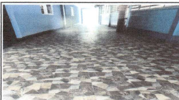
Foto 10: Sustrucción por piso Cerámico Corredor
